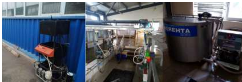
Fig. 2 Instalația frigorifică combinată pentru răcirea laptelui cu frig natural (a) și artificial (b)
