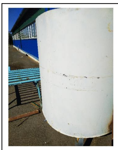
Fig. 2.6 Acumulatorul cu frig natural pentru răcirea laptelui la Complexul Didactico-Experimental al UASM
