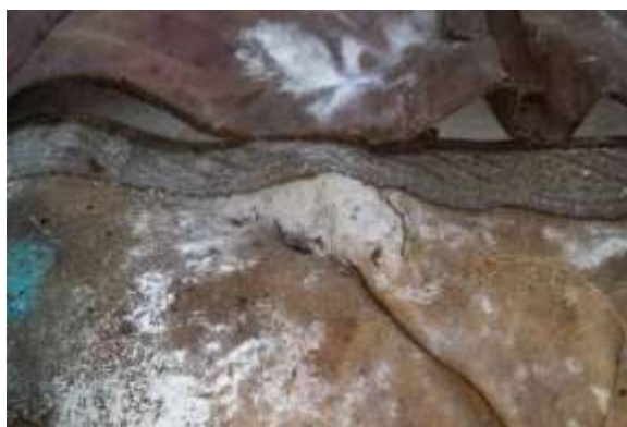
Foto 3. Depuneri săruri, produși de coroziune
