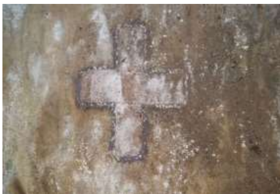
Foto 3. Depuneri săruri, pământ. Înainte de conservare
