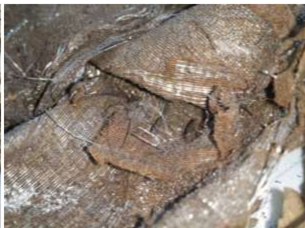
Foto 5. Fire metalice rupte, desprinse, lipsă
