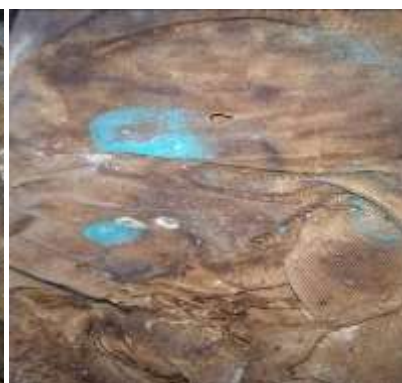
Foto 7. Depuneri produși coroziune
