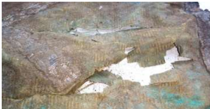
Foto 5. Rupturi cu lipsă de material
