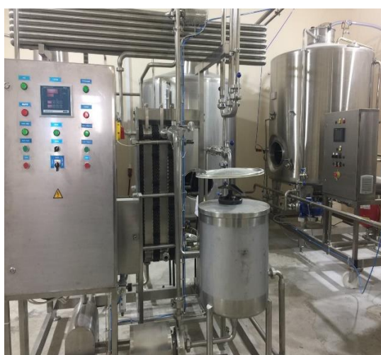
Fig.A.1.4. Instalație și panoul de comandă automatizat
